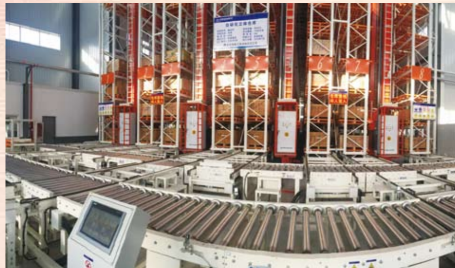
北自所（北京）科技发展有限公司的自动仓储系统。
